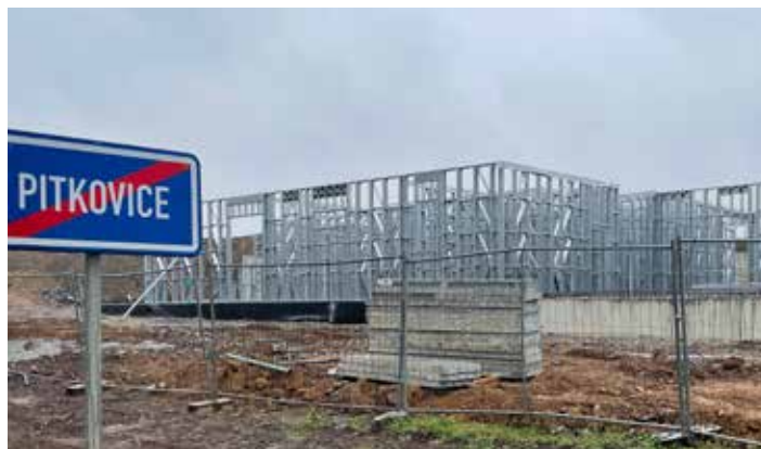
Dnes už zbouraná zrezlá konstrukce Polyfunkčního domu, z dob již bývalého starosty.
